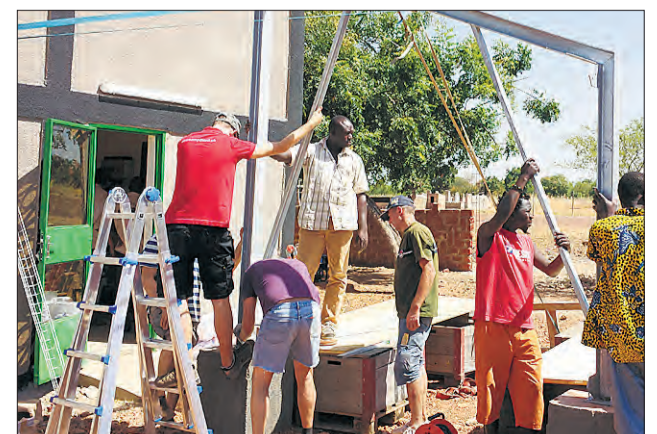
Beim Gerüstbau der Photovoltaikanlage halfen auch Einheimische mit. Die Anlage versorgt 16 Gebäude mit Strom.
