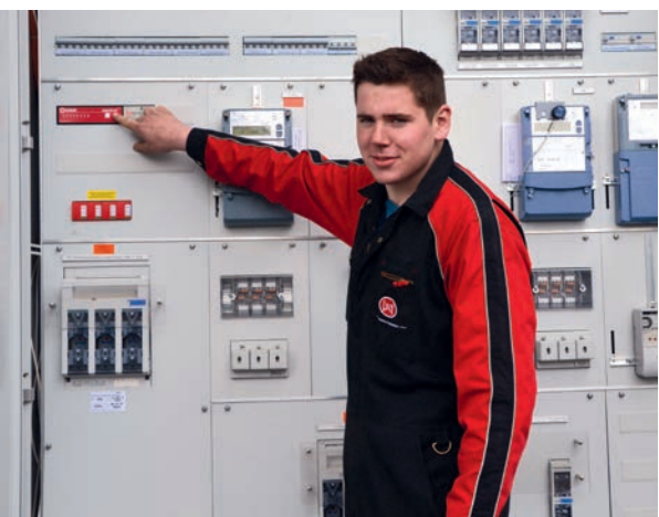
Silvan Bucher koordiniert Stromproduktion und -verbrauch mittels Energiemanager.
